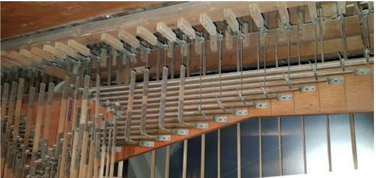
Ulteriore particolare dell'immagine precedente per evidenziare la conformazione dei catenacci in leggero tubolare d'ottone e dei tiranti più corti in semplice filo, sempre d'ottone, senza il corpo in sfoglia d'abete.
