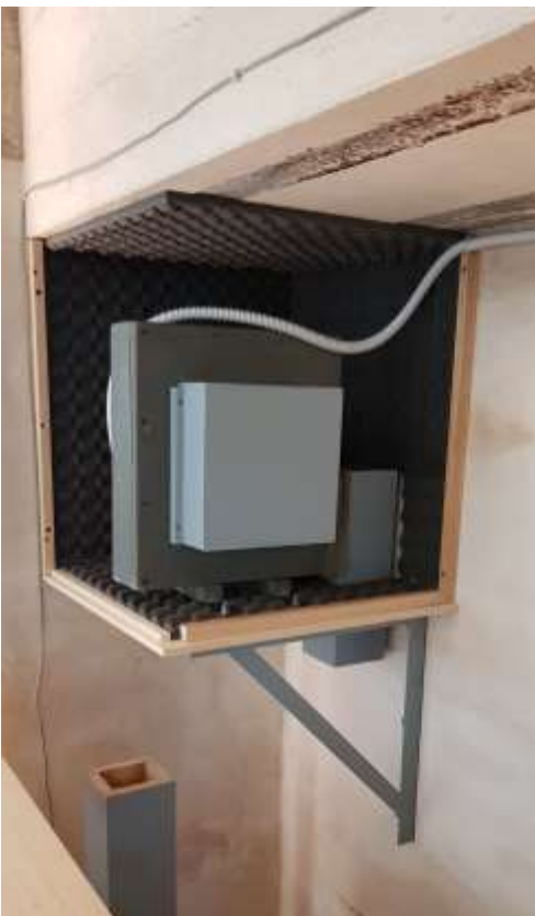
L'elettroventilatore nella nuova collocazione.
